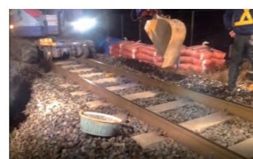
■写真6 噴泥部の掘削前の状況
