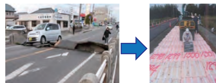
■写真5 道路の液状化被災と対策工
