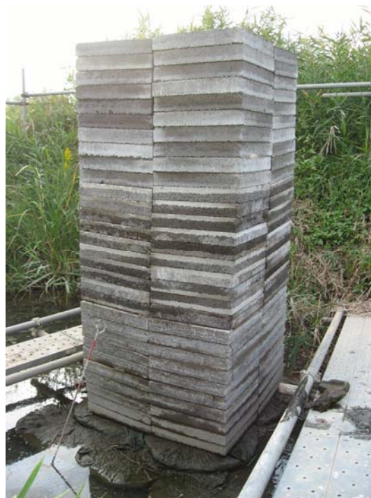
図-9 沼地（深さ約 2m のヘドロ層）載荷試験での D・BOX 上のコンクリート平板の積層状態（80cm×80cm×高さ約 1.9m）
